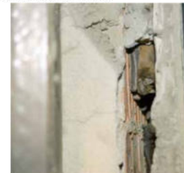
Bei Abriss und Sanierung von Gebäuden gehen viele, meist kaum sichtbare, Fledermaus-Quartiere verloren. Fledermause nutzen jedoch Spalten und Ritzen, auch Dachböden werden gern angenommen. (Foto: W. Hildebrand)
